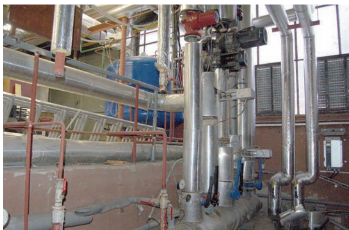
Předávací stanice Osvoboditelů – čerpadla vytápění a větev pro školy.
