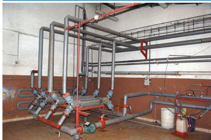
Předávací stanice Osvoboditelů – ohřev vody pro Sady pionýrů. Výměníky JAD. (3x foto: tuc)
