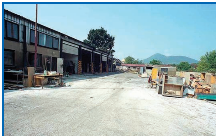
Terežinská ulice, poškozené garáže Záchraného hasičského sboru po povodni v roce 2002. Zatímco hasiči pomáhali jině, voda úplně zničila jejich zázemí. Na dlouhou dobu (i po deseti letech) tak Lovosice zůstaly bez hasičů. (foto: hv)
